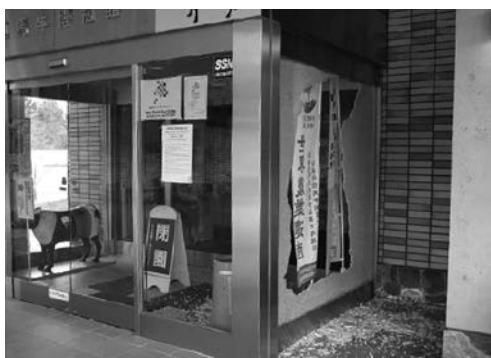
但馬牛博物館の破損状況(現在は修繕済み)
