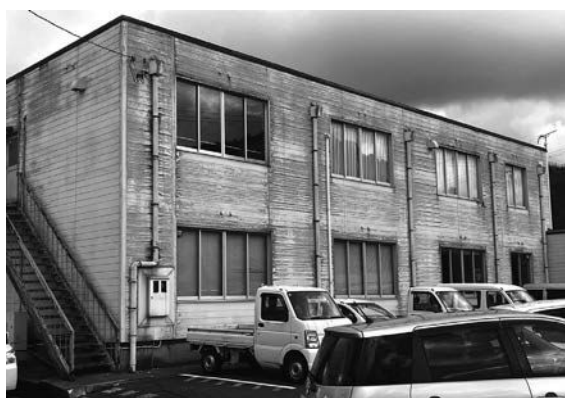
外壁がひどく劣化している浜坂福祉センター
