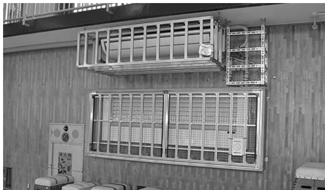
学校体育館の空調（エアコン）整備
