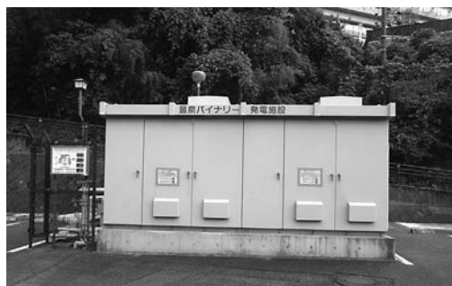
非常時のみ稼働するバイナリー発電施設
