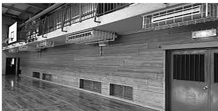
体育館の空調（エアコン）設備
