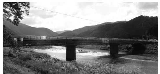
何度も契約変更となった新市橋、早期の復旧が待たれる
