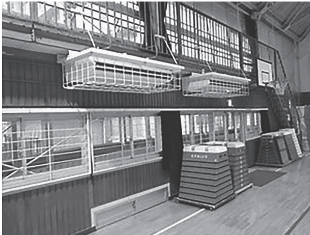
体育館空調設備
