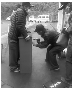
消火栓等の実質的な保守は地元の消防団がおこなっている
