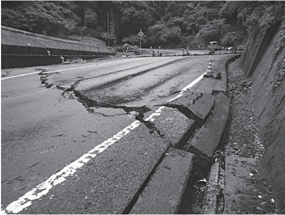
久谷桃観線の路面変状の状況
