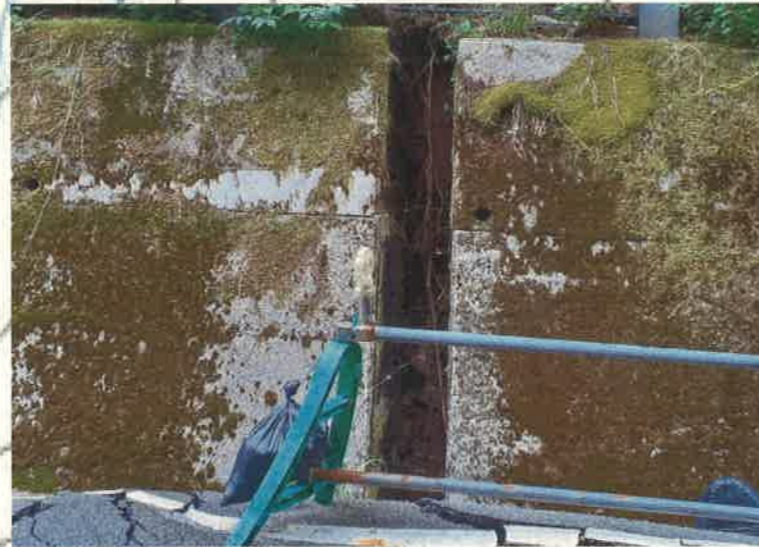
山側擁壁のズレ
