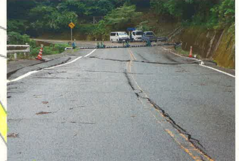
道路上の亀裂の様子
