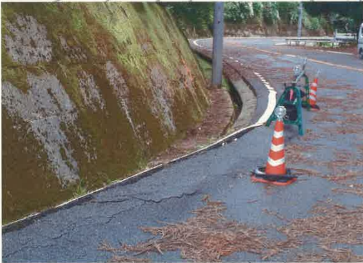
道路路肩の沈下(山側)
