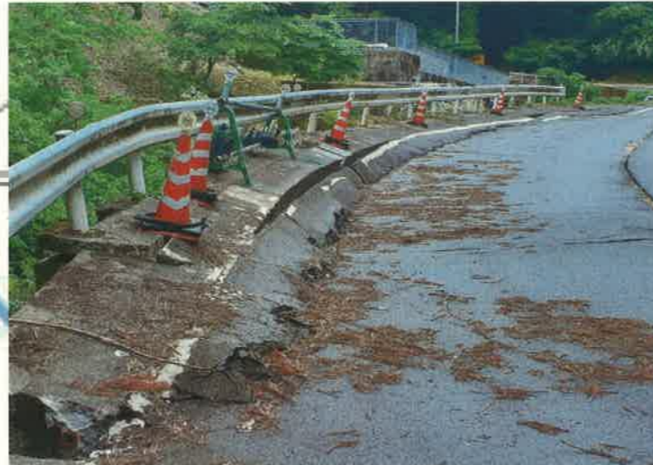
道路路肩の沈下(河川側)
