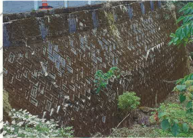
河川護岸擁壁の亀裂
