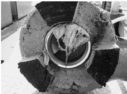
中継ポンプに布が絡んで故障
