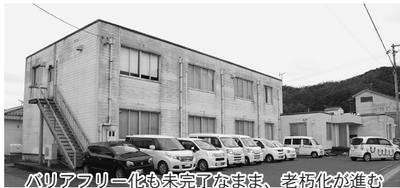
バリアフリー化も未完了なまま、老朽化が進む 浜坂福祉センター
