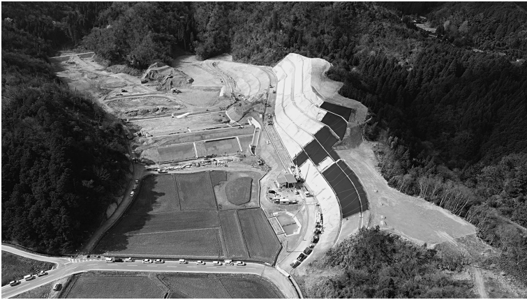
建設中の和泉谷残土処分場。浜坂道路Ⅱ期工事などの残土を受け入れる。
