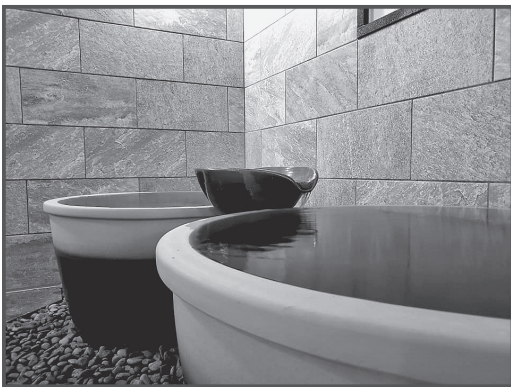
↑その他、つぼ湯の設置、天井の張替、低温サウナの床壁の改修等を行っています。
