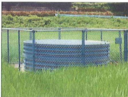
集水井（しゅうすいせい）
