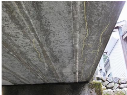
主桁にひび割れが見られます
