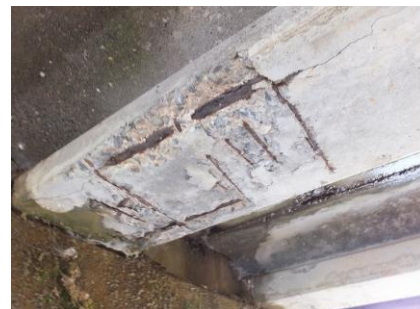
主桁の鉄筋が露出しています
