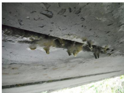
床版に遊離石灰が見られます
