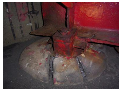
支承が損傷しています
