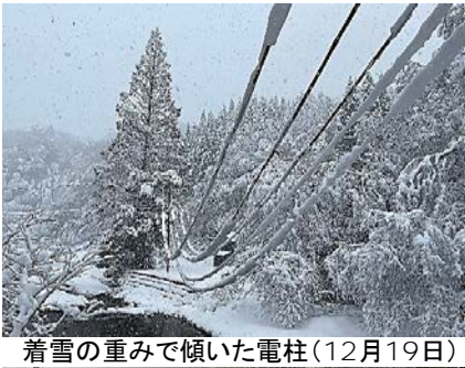
着雪の重みで傾いた電柱(12月19日)
